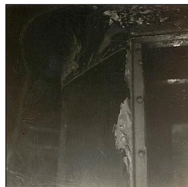
Ohořelá kabina výtahu, 1938 (požárý.cz)
